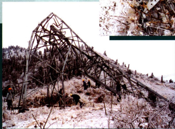
①、被冰雪压跨的拓民线235号铁塔
