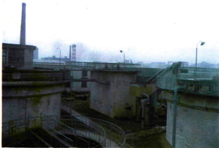
温州啤酒厂污水处理设施（张文龙摄）
