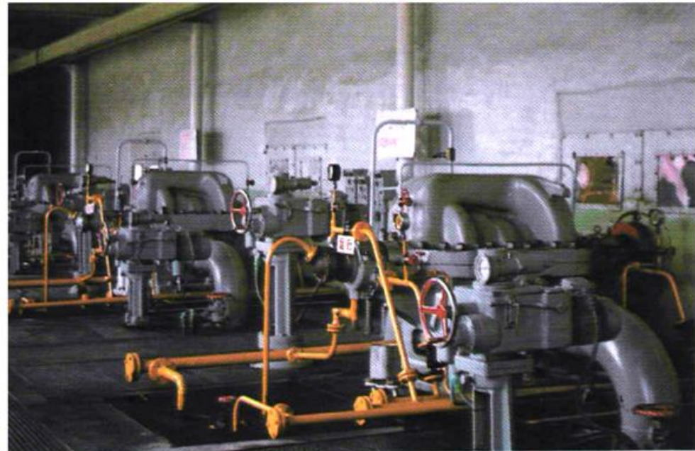
沧州输油站泵房
