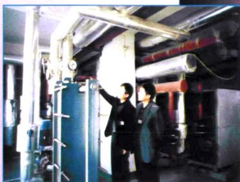
中央空调机房
