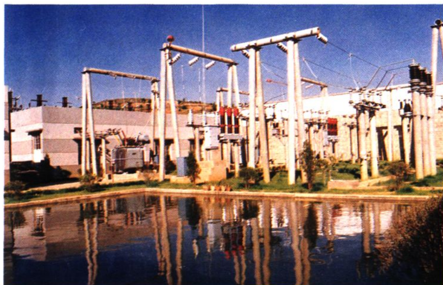
▲ 青龙哨变电站
