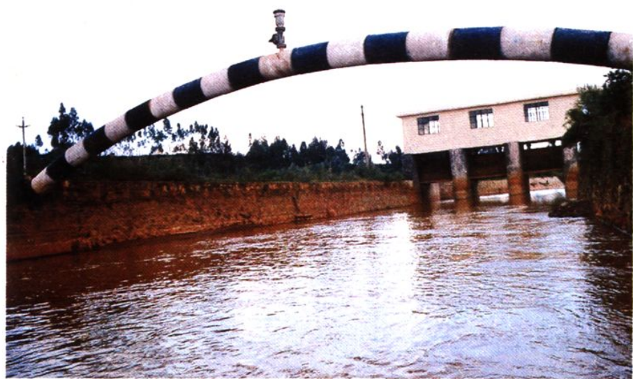
► 铜车坝抽水站供水管道及拦河闸
