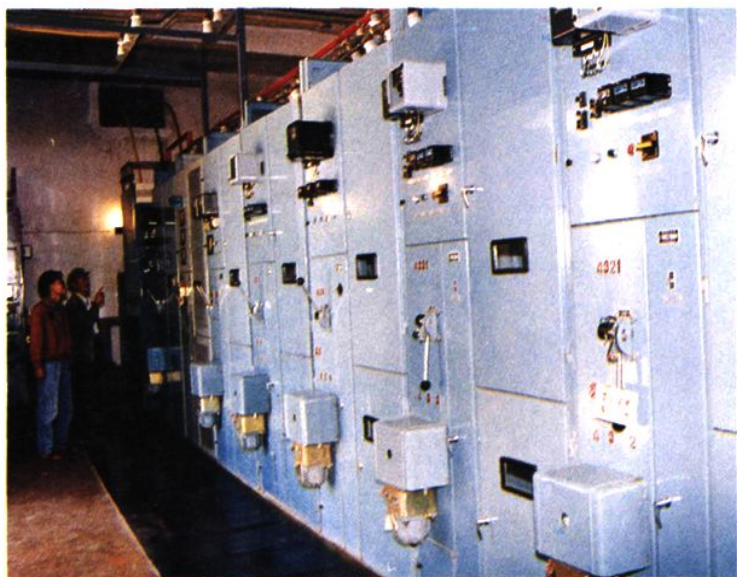
八街变电站主控室 ▶
