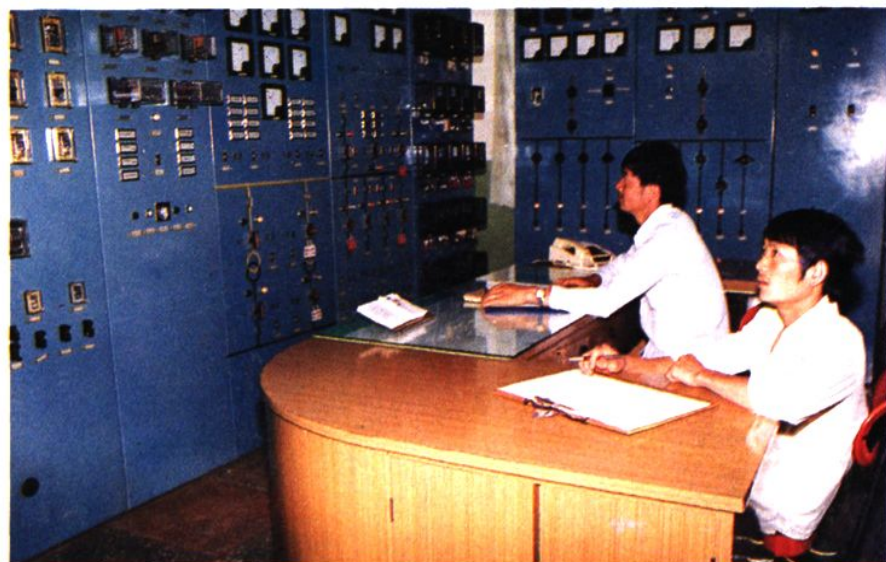
▲ 县街变电站主控室
