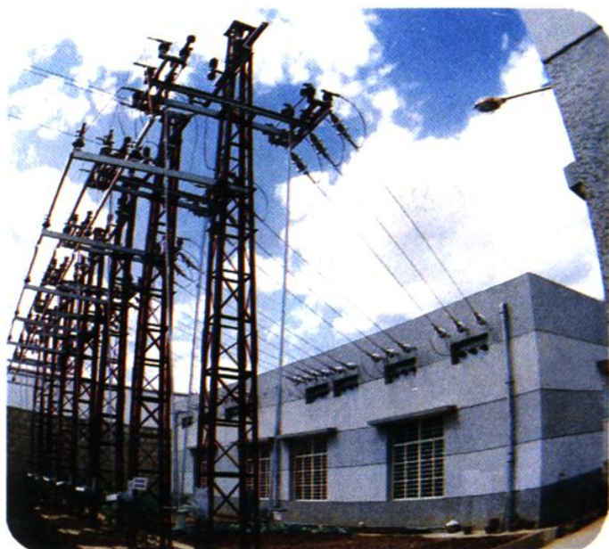
青龙哨变电站出线 ▶
