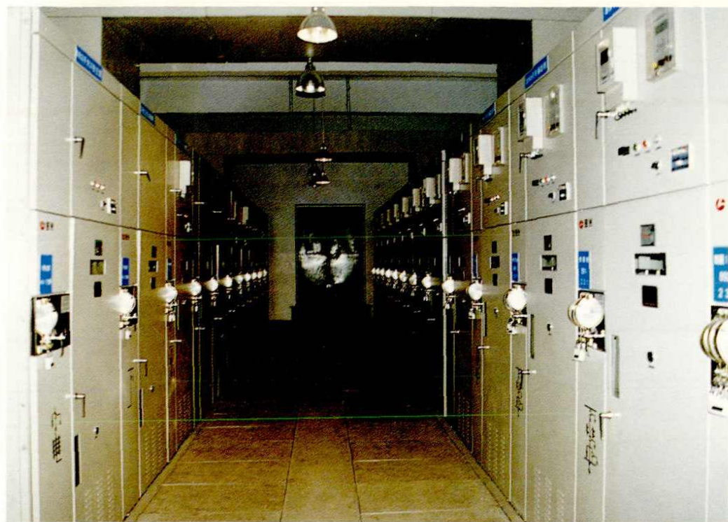
110 千伏北郊变电站控制设备
