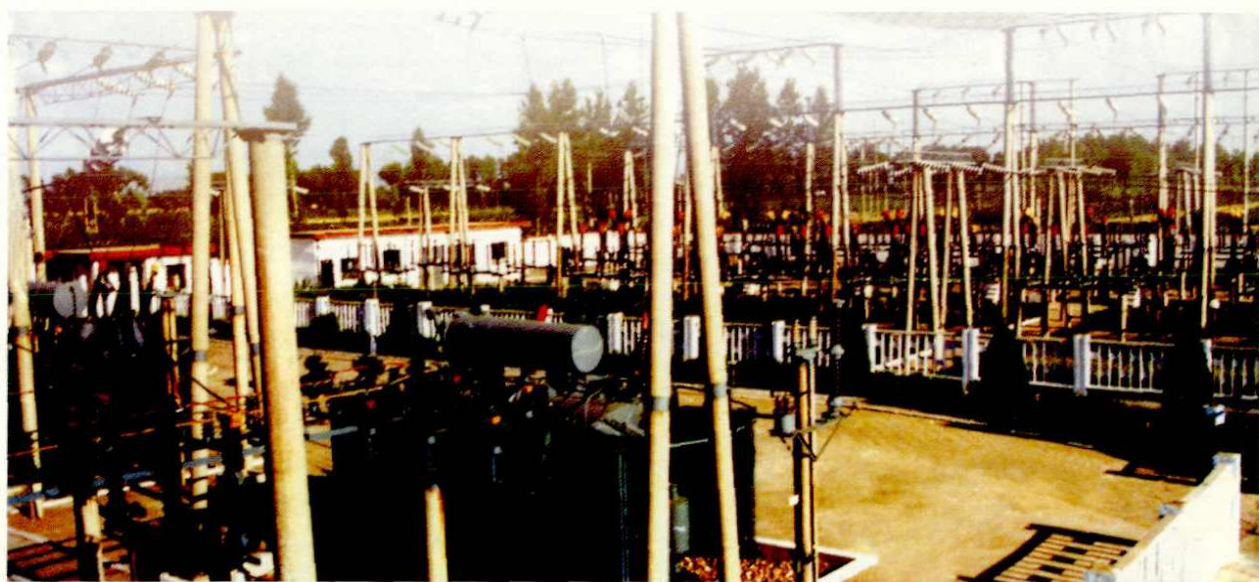
110 千伏西郊变电站
