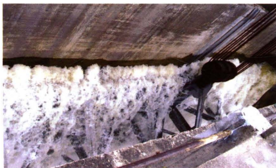
2003年新沟闸闸门漏水险情。
