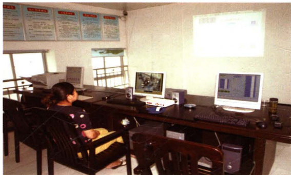
2006年，完成更新改造的鲢鱼地泵站，实现了泵站运行调度自动化控制。
