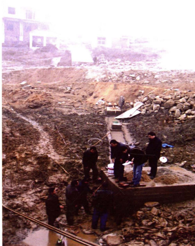
大悟县彭店水库东输水管多次发生险情，汛期过后放水筑堰，2007年12月，工程技术人员在现场研究处理方案。
