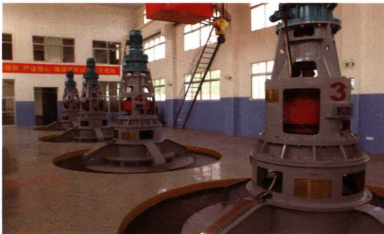
2007年，完成更新改造后的汉川大沙泵站内景。
