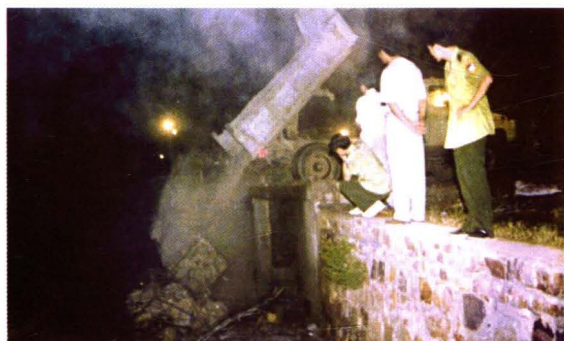
1998年8月18日18时，汉北河民乐闸发生重大险情，工程技术人员组织车辆和抢险物资连夜抢险。
