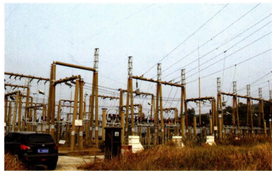
五里牌变电站
