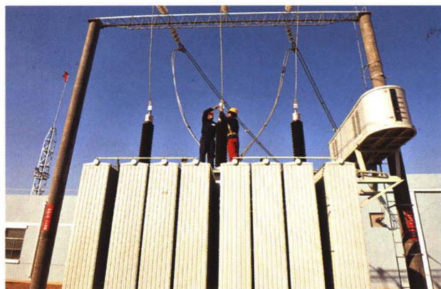
京九线任丘牵引变电所
