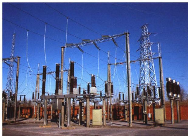
精伊霍线伊宁东牵引变电所
