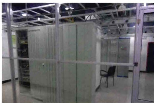
华蓥市广电网络数据机房
