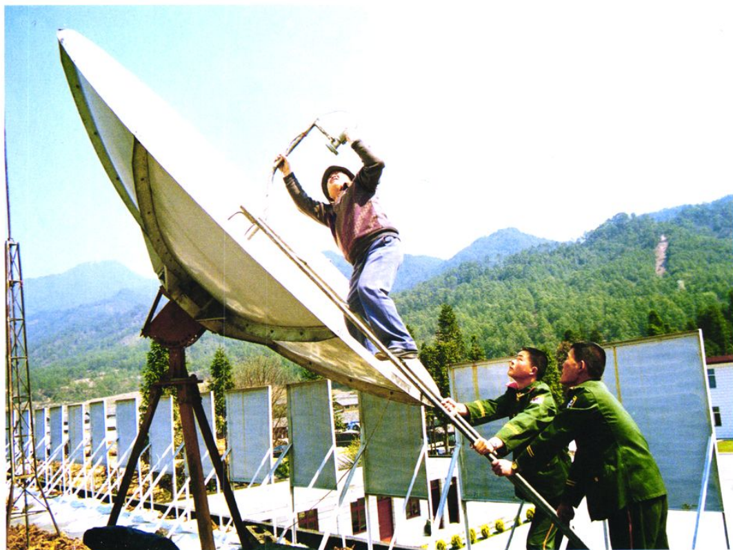
正在安装调试的腾冲县滇滩口岸卫星电视地面收转站。
