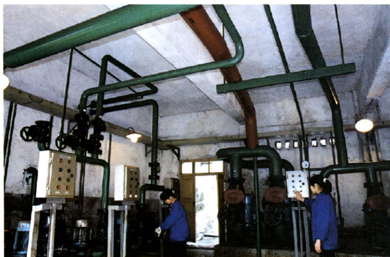
发电厂软水处理一角
