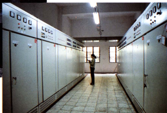
焦化系统配电室一角
