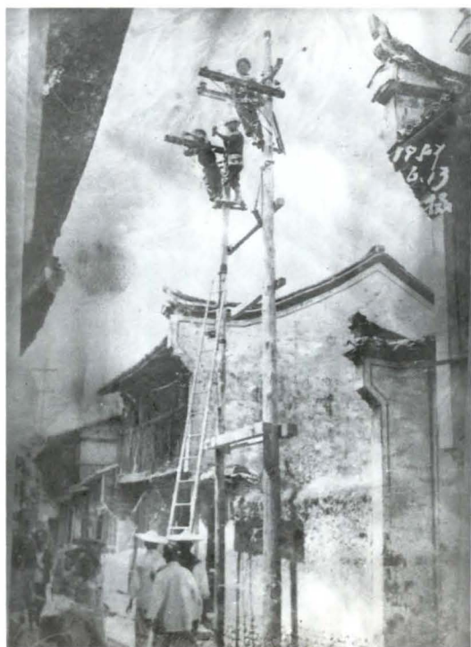
1957年8月县城安装第一台20千伏安变压器
