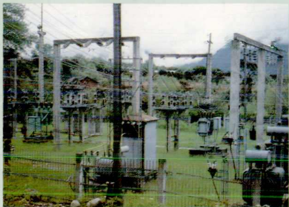
林芝八一电厂升压站。
