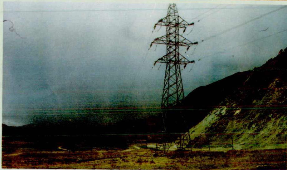
纳金电站至北 郊变电站 35 千伏输电线路。
