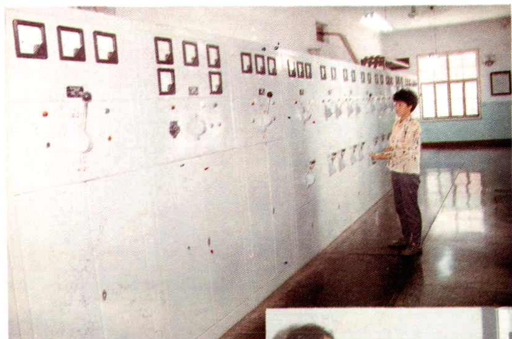
3 · 5 千伏配电系统一角
