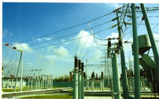
110千伏南漳变电站站貌（2007年10月摄）
