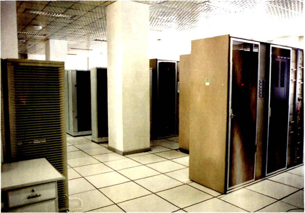
1991年开通时的移动通信交换机设备
