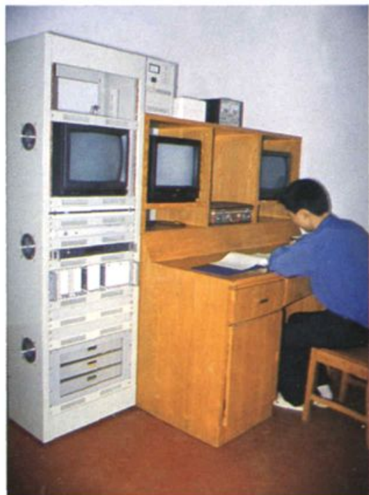
县有线电视台的前端机房
