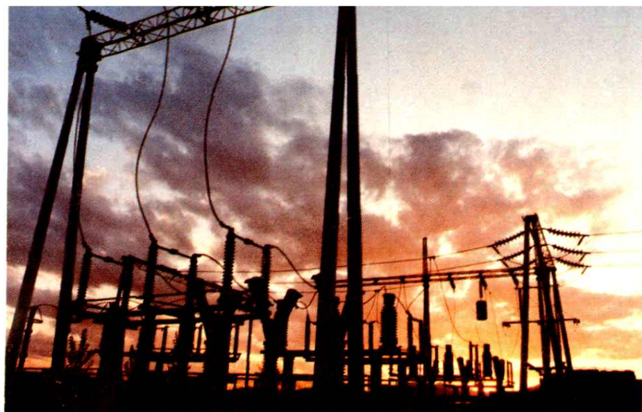
十一万伏变电站
