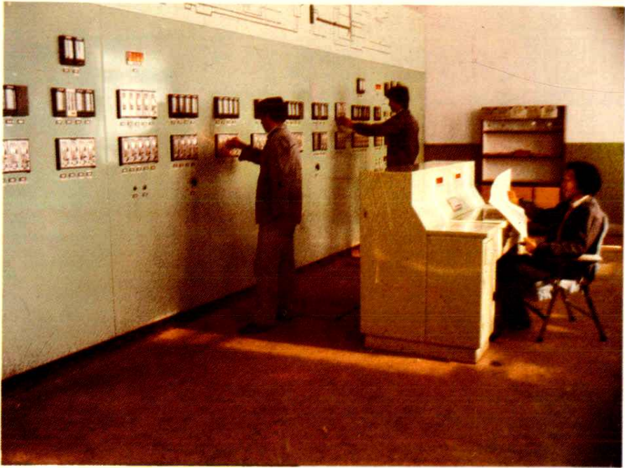
常减压车间操作室
