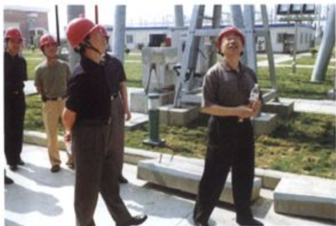
2002年6月3日,国家电力公司顾问周小谦(右一)在嘉兴视察500千伏王店变电所
