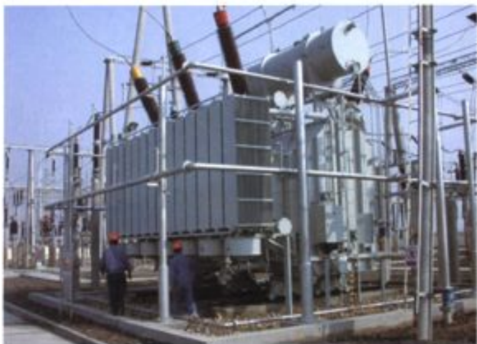
2000年,嘉兴市第一座220千伏基建移交达标生产的综合自动化变电所——秀水变电所
