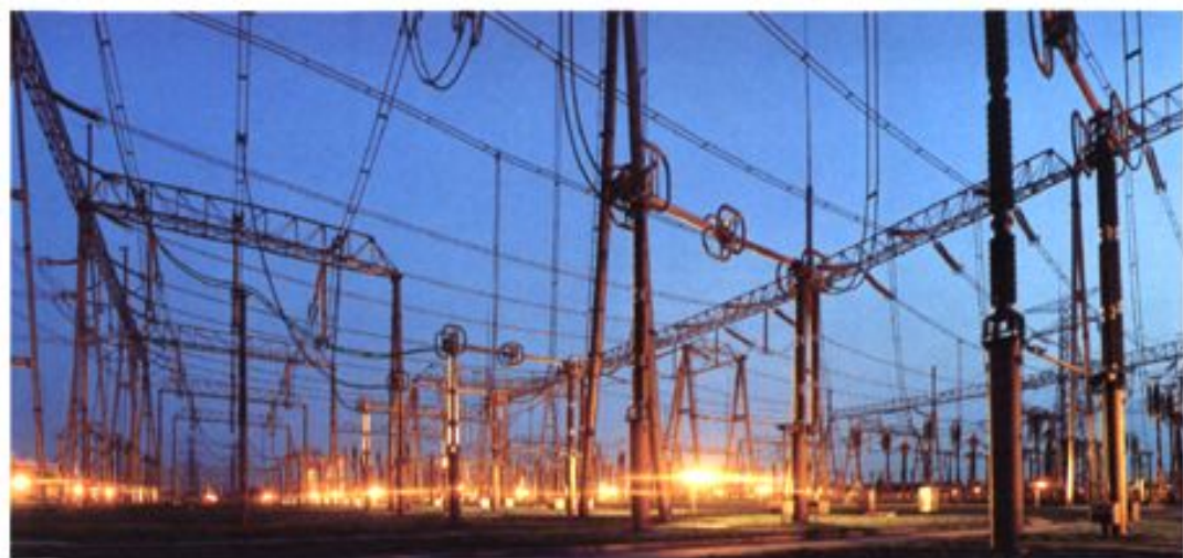
嘉兴市第一座 500 千伏变电所——王店变电所
