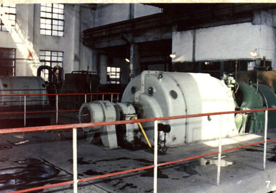
7. 兴县发电厂 6000 千瓦发电机组
