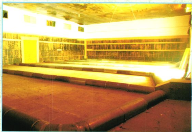
粮油仓库机械通风设施
