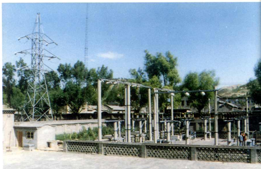
米脂城关变电站
