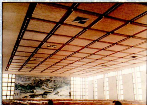
上海新型建材厂生产的TK板用于上海十六铺客运站候船大厅
