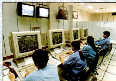
上海水泥厂 2000吨干法窑中央控制室
