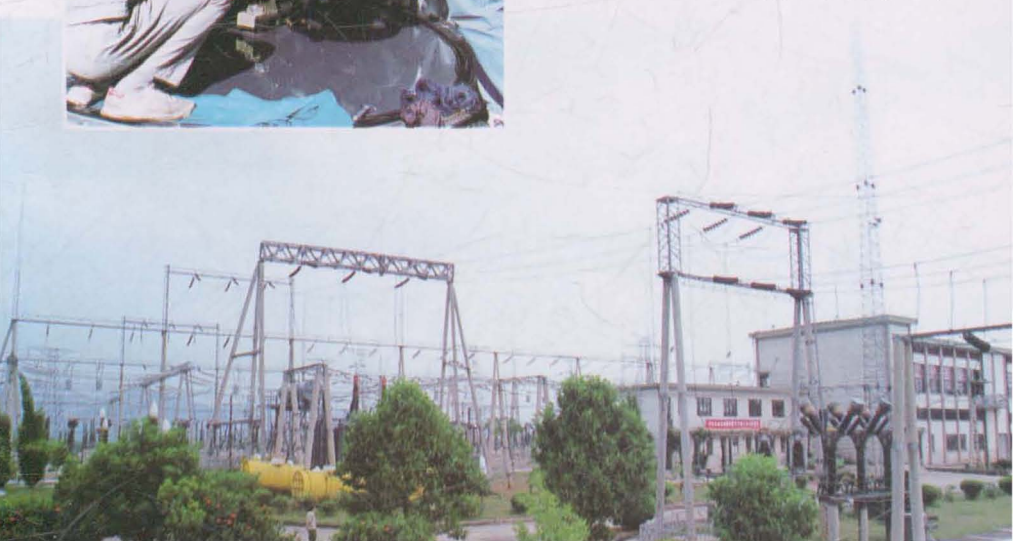
16 220千伏李林变电站
