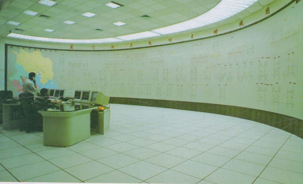
7 厦门地区电力调度室
