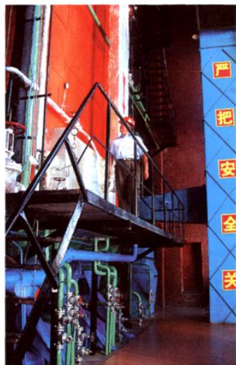
电厂锅炉车间
