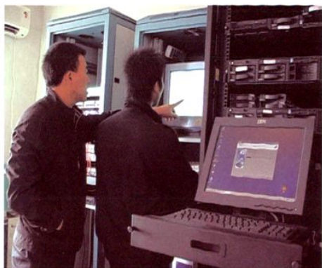
五九(集团)公司网络系统总服务器机房
