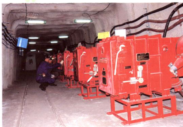
井下标准化高压开关硐室
