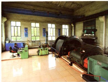
牙煤一矿主提升系统
