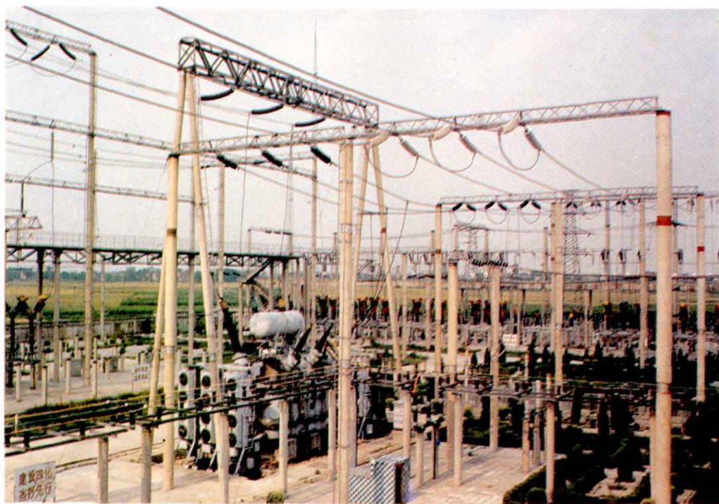
丹阳 220 千伏变电所
