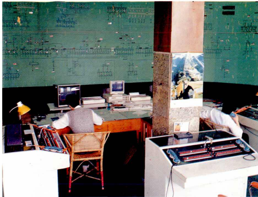
镇江供电局调度室
