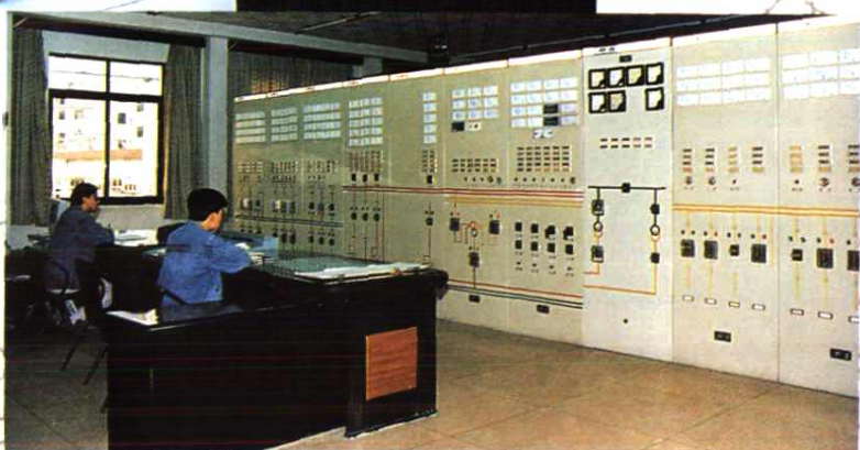
110 千伏磐安变电所调度室
