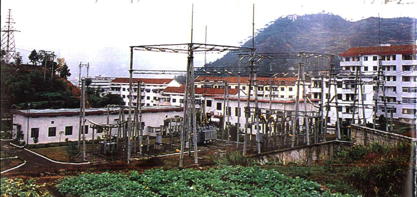
110 千伏磐安变电所
