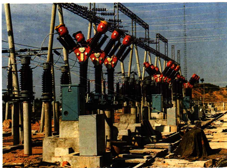
罗桥变电站设备（局部）
