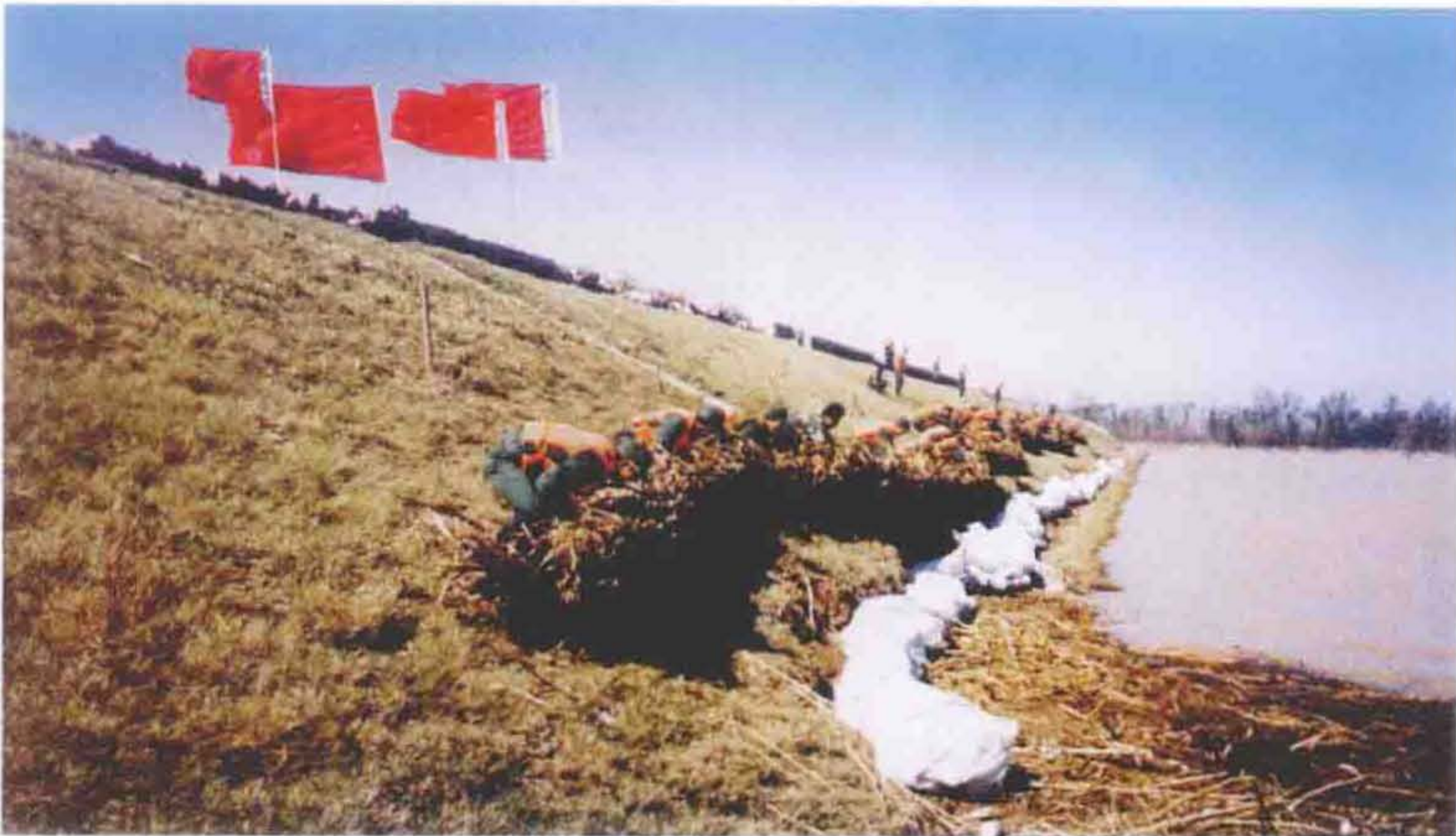
2003年10月，东明黄河堤防工程出现风浪险情，武警官兵正在抛枕抢护
