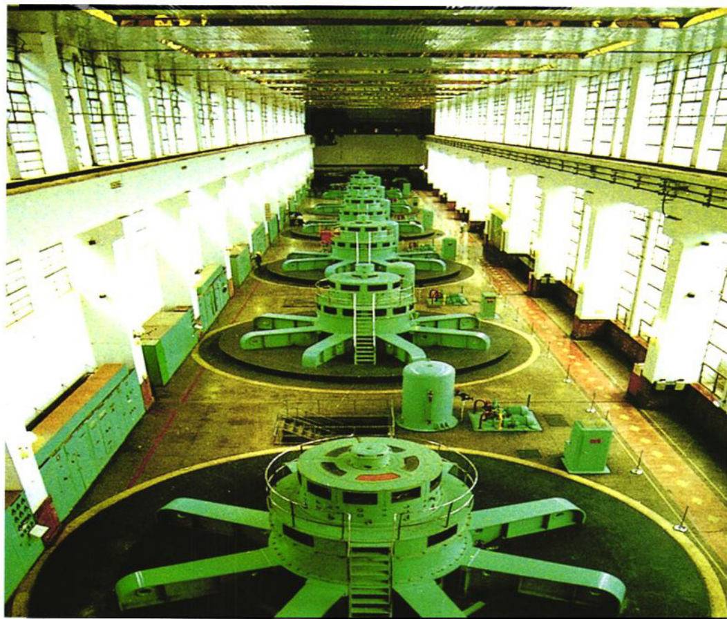
柘溪水电站发电厂房
