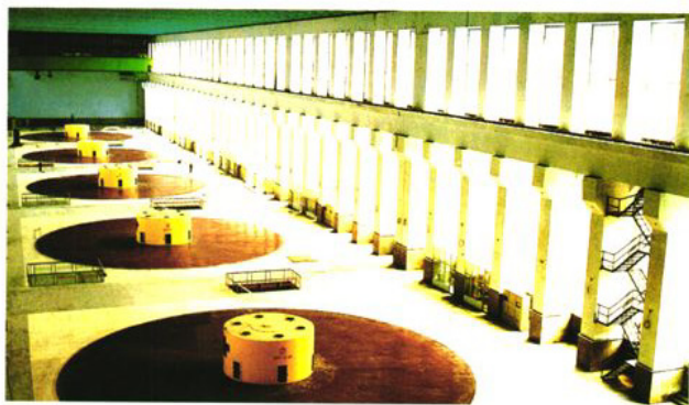
五强溪水电厂发电厂房
