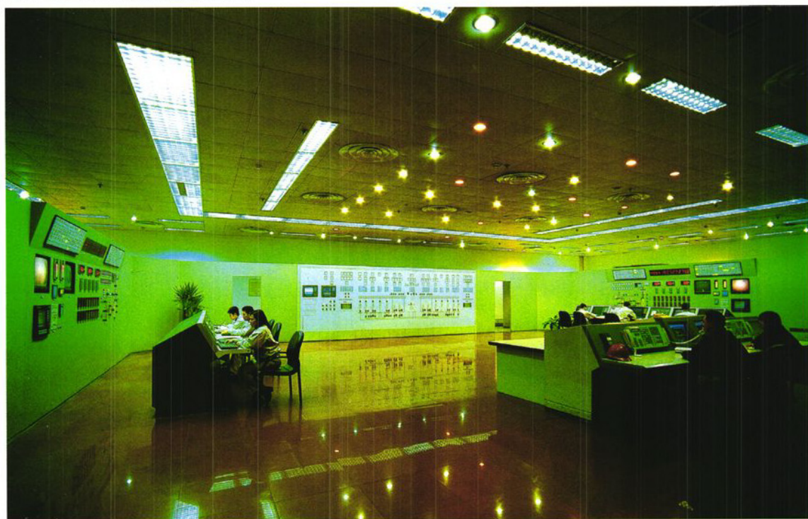
湘潭电厂中央控制室
