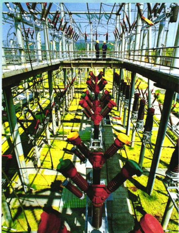
220千伏长沙天顶变电站
