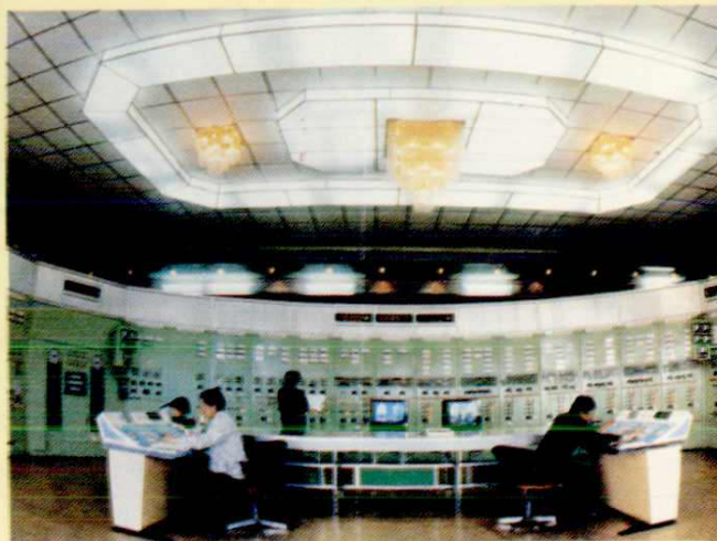
清河发电厂主控室之一
