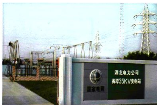
黄潭35KV变电站
