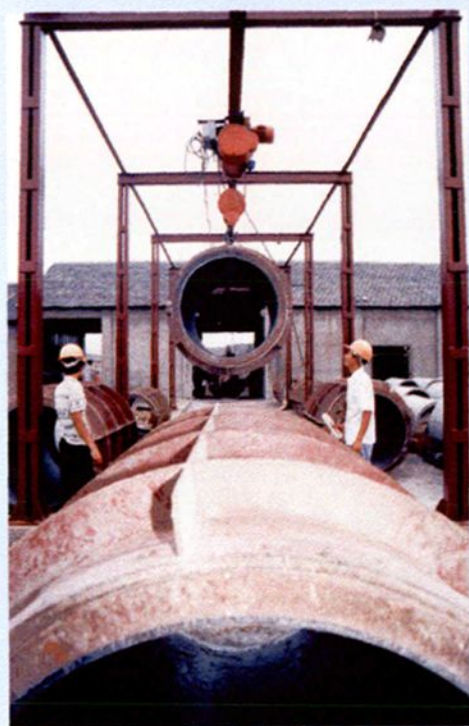
政大构件公司涵管生产线(1998年)
