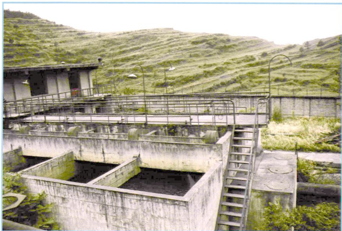
净化站虹吸滤池
