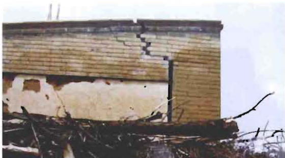
1987年灵武5.5级地震，墙体裂缝
