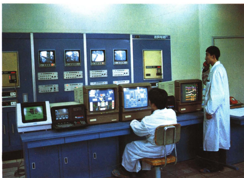
首都钢铁公司 三号高炉控制室
