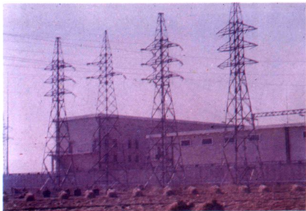
110千伏车墩站35千伏出线塔
