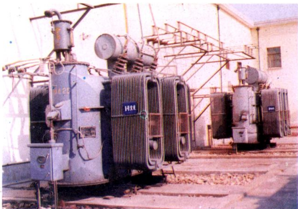
新建南门变电站 1 号、2 号主变
