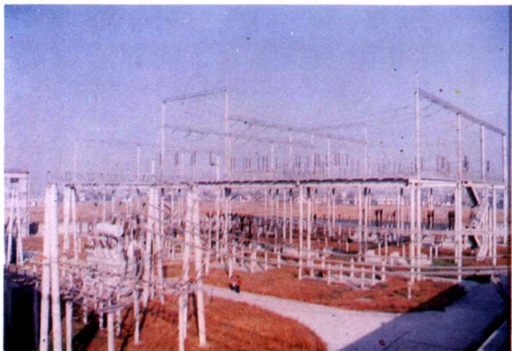
220千伏新松江站全貌
