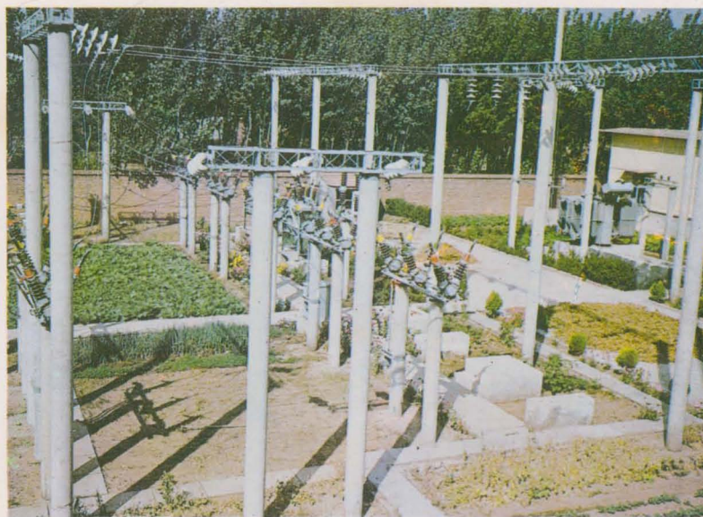
马站35千伏变电站
