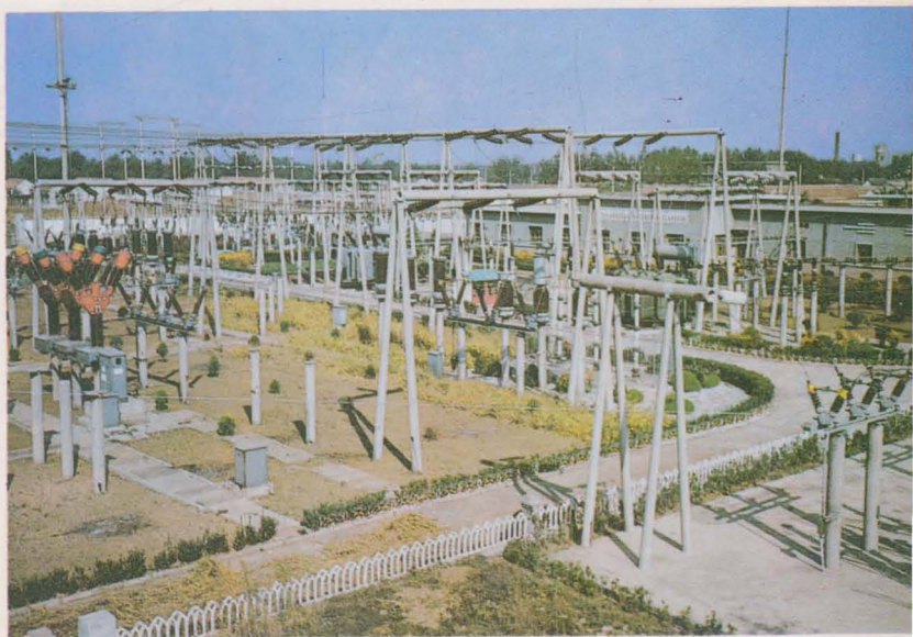
沂水十一万变电站
