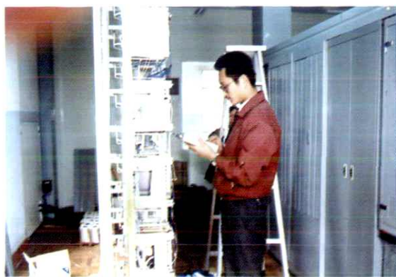
► 光电传输机房
