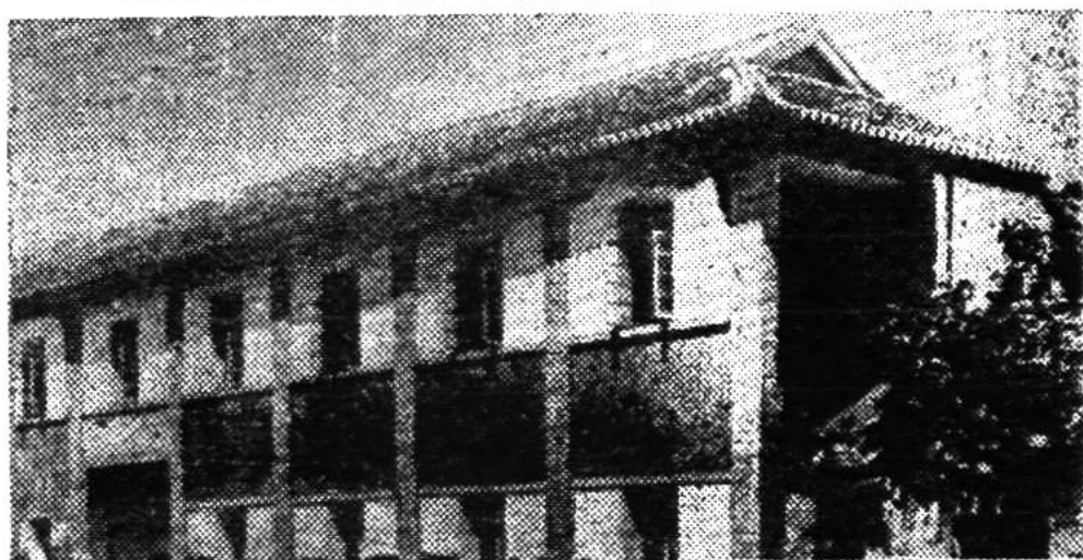
照片2：芒市旅社，北墙上部倒塌，墙上多处裂缝， 房瓦滑落。
