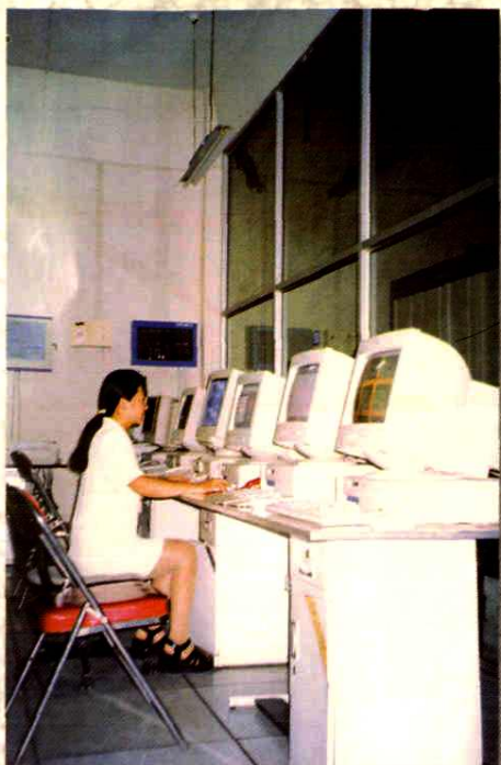
县局程控机房
