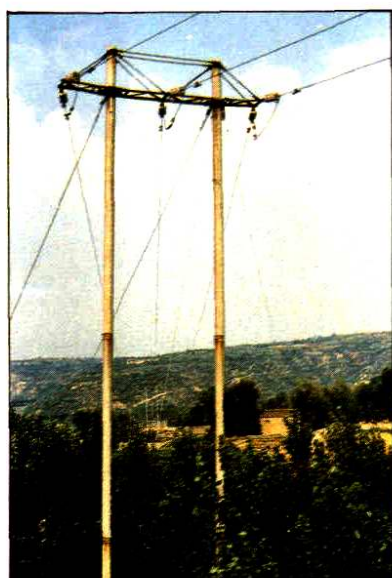
阳城电厂至加丰电厂 35 千伏线路
