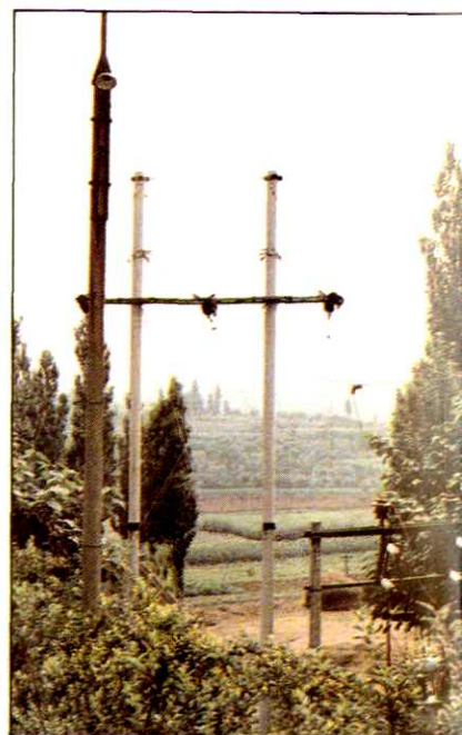
阳城电厂——次营 35 千伏线路杆塔
