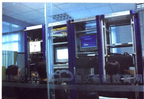
区教育城域网中心机房
