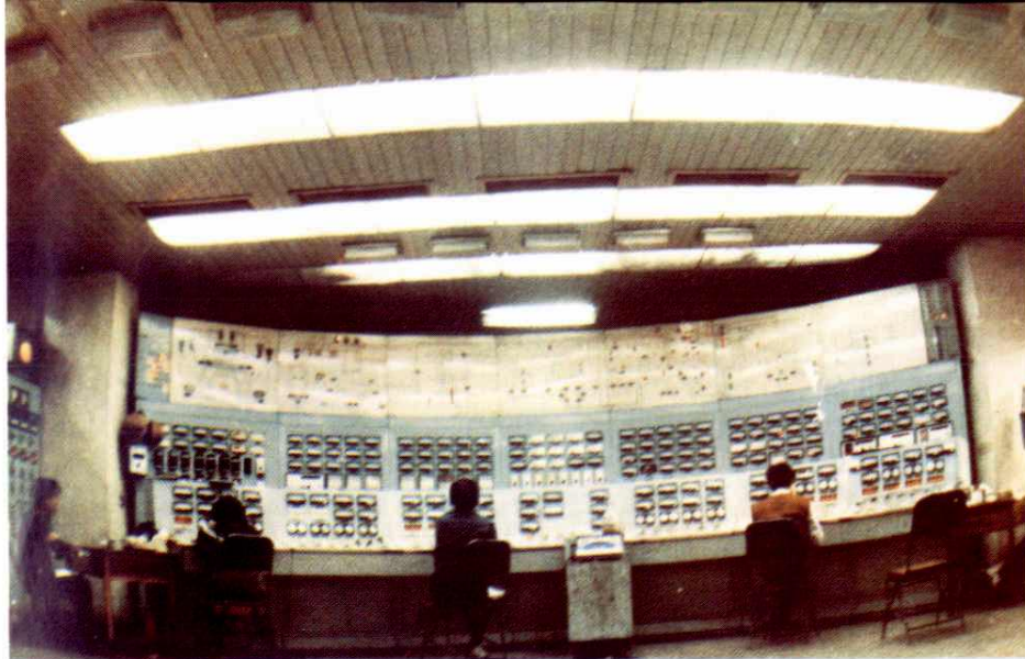
淮南田家庵发电厂 国产12.5万千瓦机 组集中控制室
