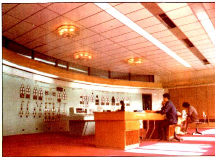
淮南洛河发电厂网络控制室
