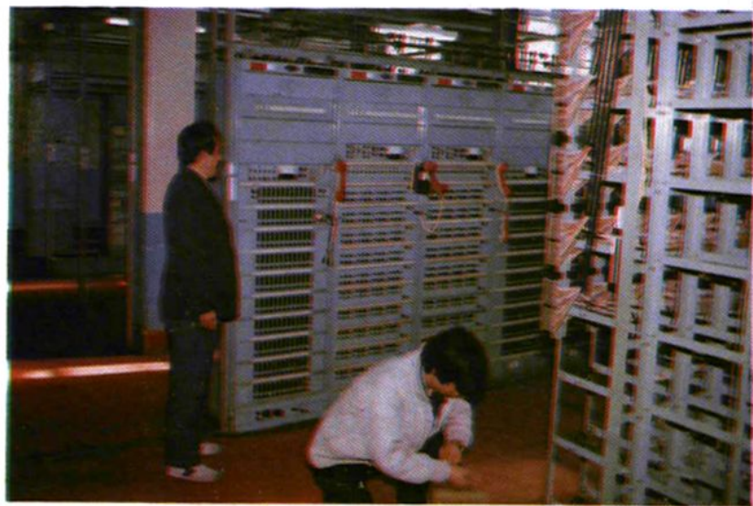
铁岭市载话机房一瞥
