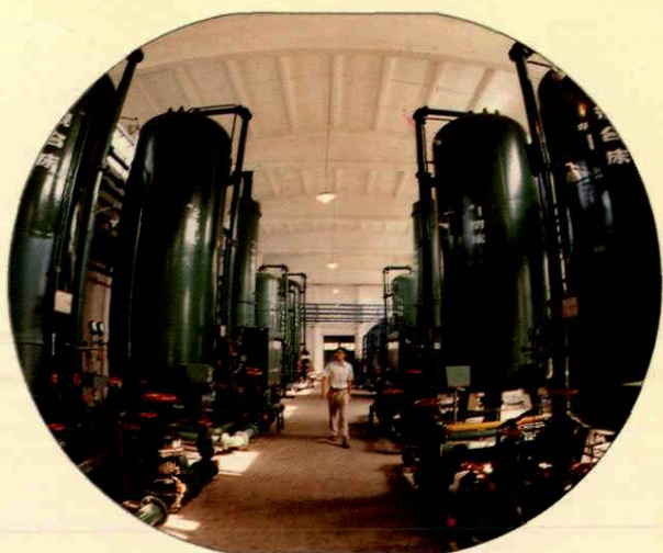
化学水处理室。
