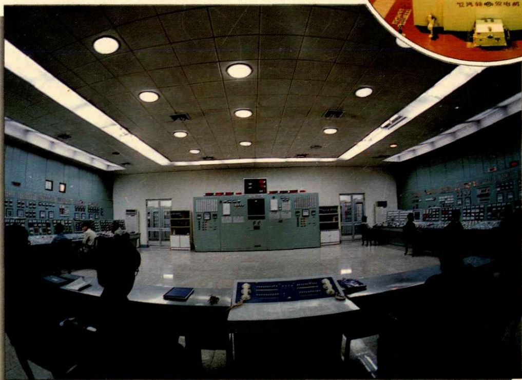
2×20万千瓦机组中心控制室。
