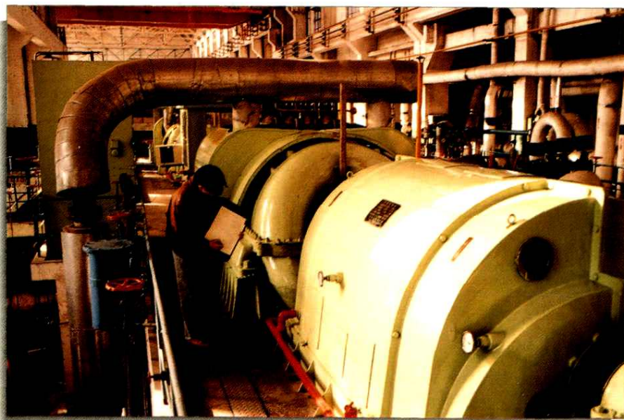
1981年9月,将一台6000千瓦机组改为对外供热机组。
