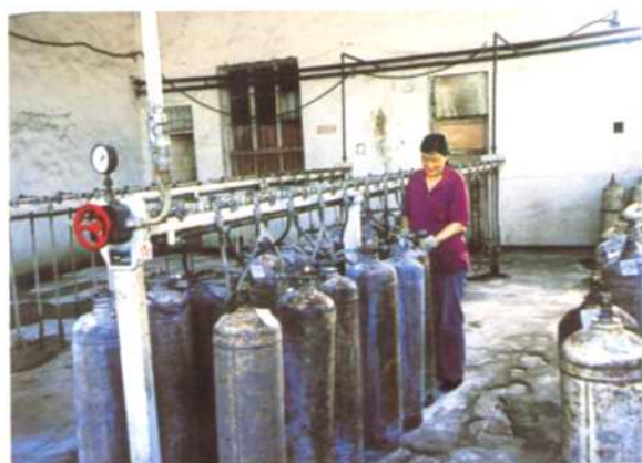
建材厂工业气体生产灌装线
