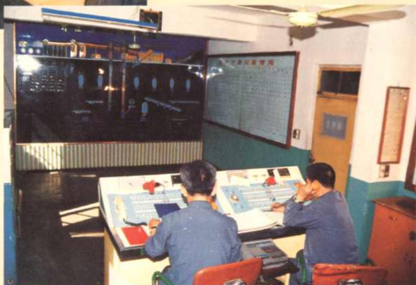
矿井生产调度系统
