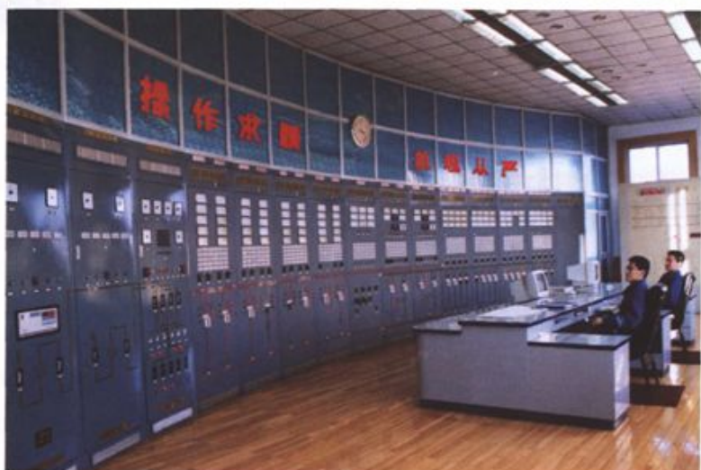
长春供电公司长春 东郊220千伏变电所主 控室
