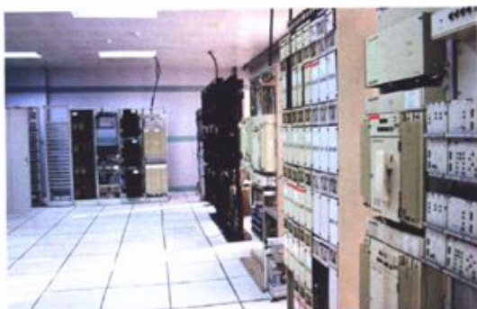
吉林省电力调度通信传输中心机房
