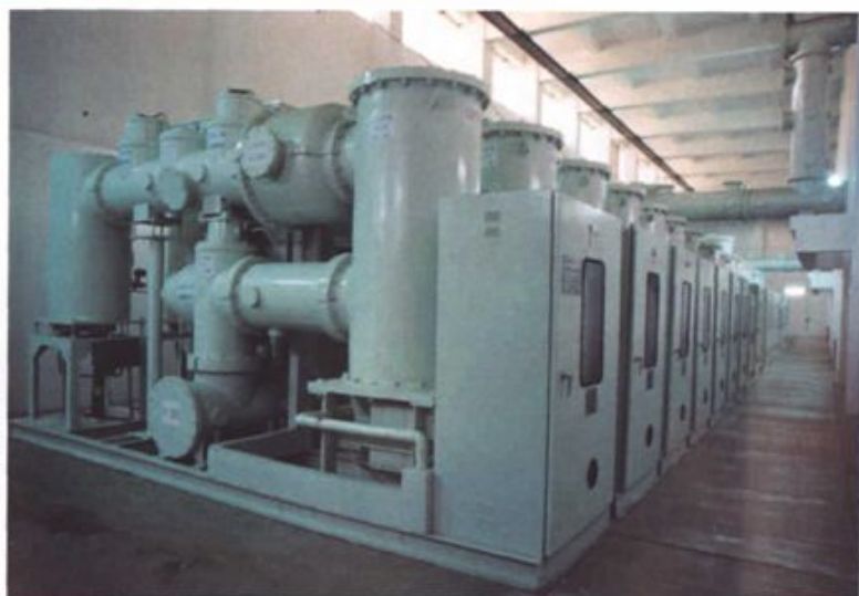
长春供电公司220 千伏平泉路室内变电所 66千伏组合电气设备
